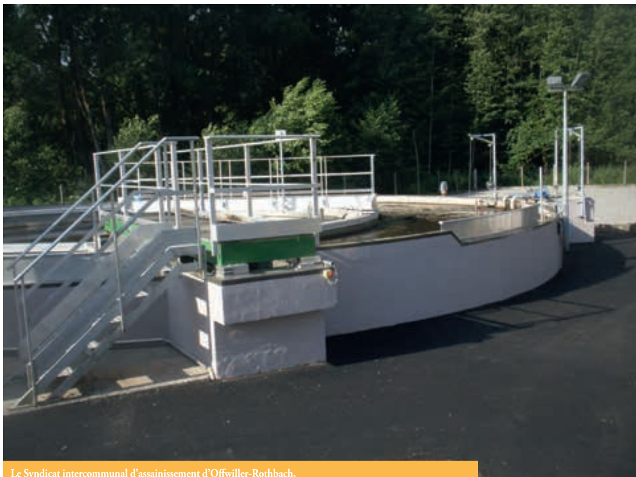
Le Syndicat intercommunal d'assainissement d'Offwiller-Rothbach, qui gère notamment la station de traitement des eaux usées située à Rothbach, sera dissous par l'effet de la loi.
